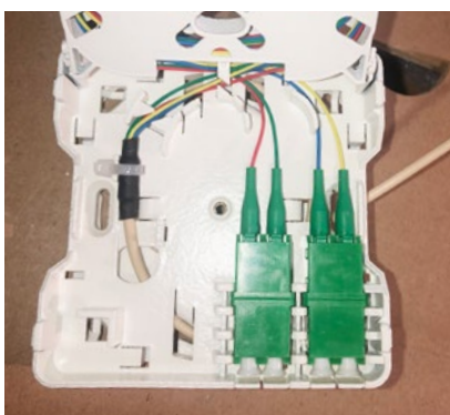
Sonderkonfiguration gemäß den Vorgaben des geförderten Glasfaserausbaus
