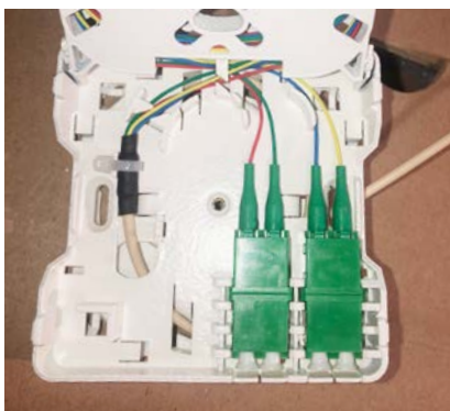
Sonderkonfiguration gemäß den Vorgaben des geförderten Glasfaserausbaus
